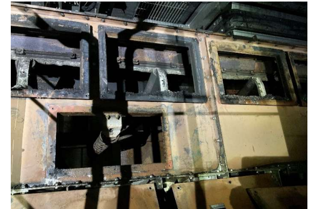
選別ごみ搬送コンベアの被災状況
