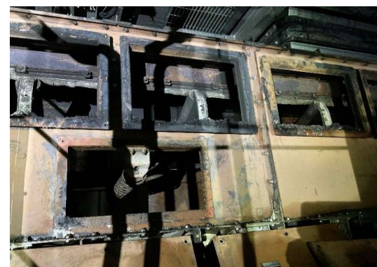
選別ごみ搬送コンベアの被災状況
