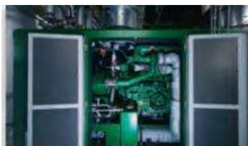
バイオガス発電機
