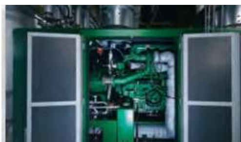
バイオガス発電機
